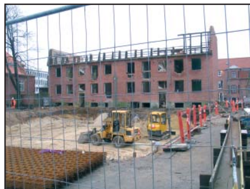
Bygningen som den så ud den 7. februar 2006. Hele taget er pillet af, og der er gravet ud til fundamentet til den nye tilbygning.
