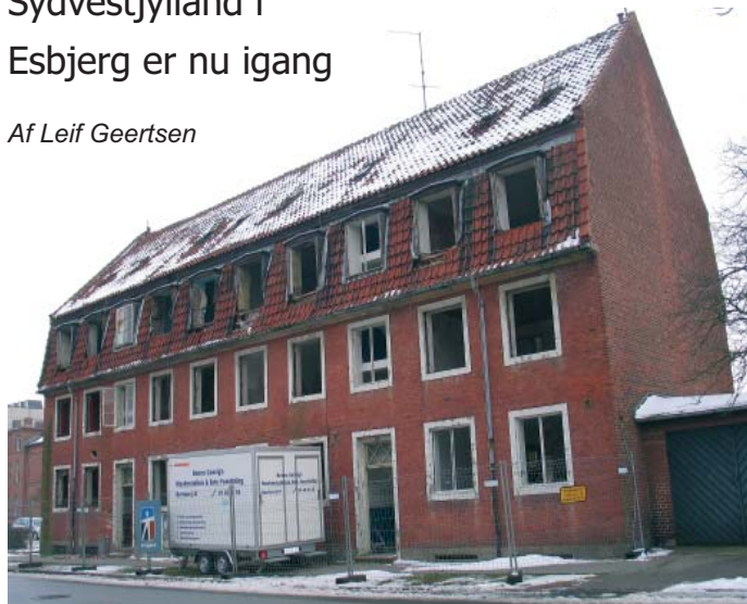
Forsiden af det nye hospice - alle vinduer er taget ud. 2. januar 2006
