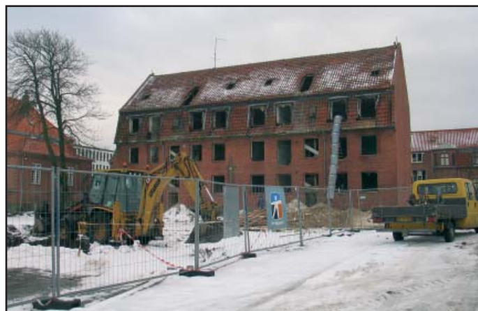
Hele arbejdspladsen er indhegnet og der arbejdes med store gravemaskiner. Den 2. januar 2006
